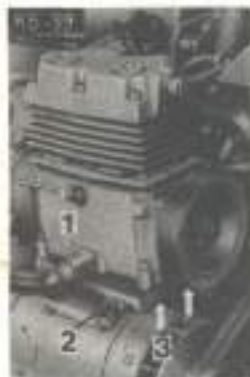
Рис. 23. Натяжение клинового ремня привода компрессора (К5-39)
